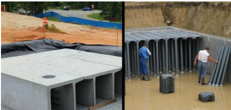
Figur 69. Underjordisk fördröjning. (Foto t.v: Exact Stormwater Management, Foto t.h: Daliform group)
